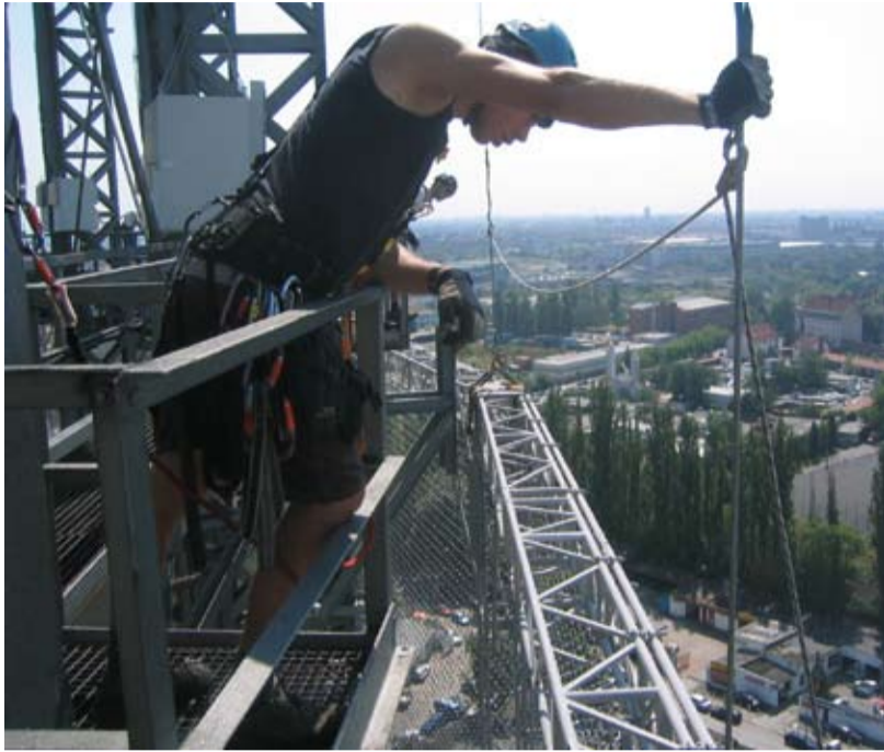
Höchste Sicherheitsvorkehrungen, tiefste Konzentration: der Gasometer fordert Höchstleistungen.
